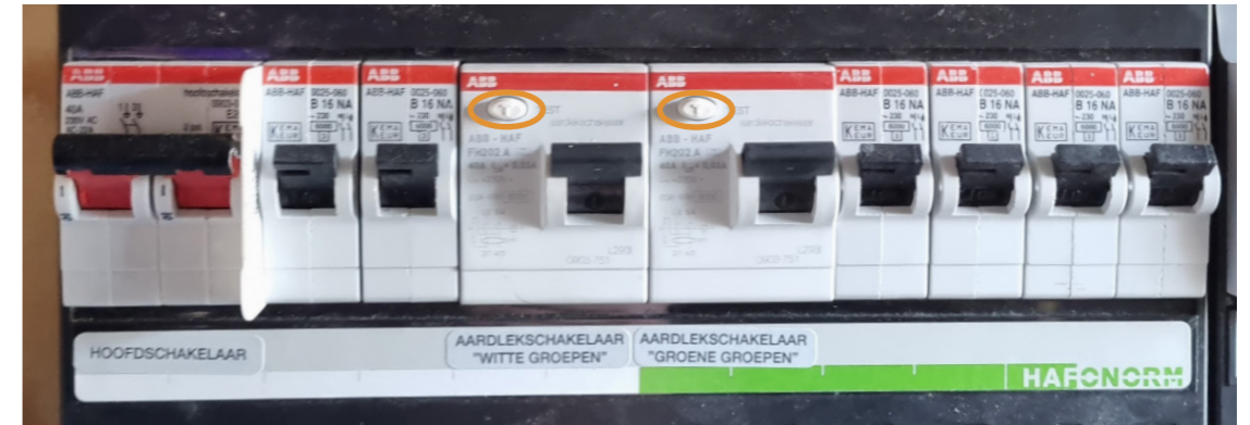
De locatie van de testknop 'T' in uw meterkast
